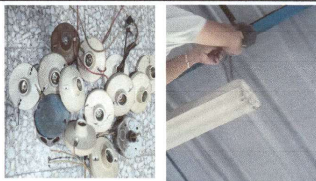
Foto 4: Se colocarán focos ahorradores de energía eléctrica.
